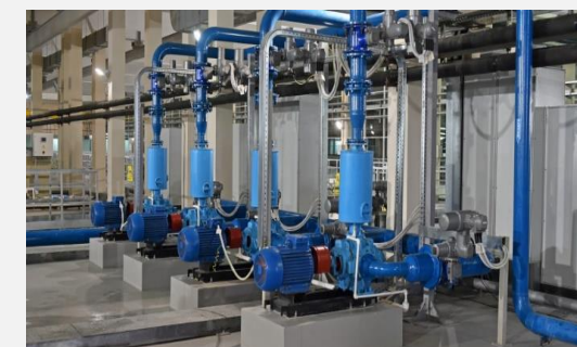
Очистные сооружения в посёлке Киевский
